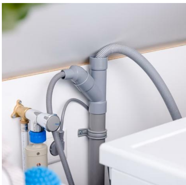
Afvoer met Y-stuk
